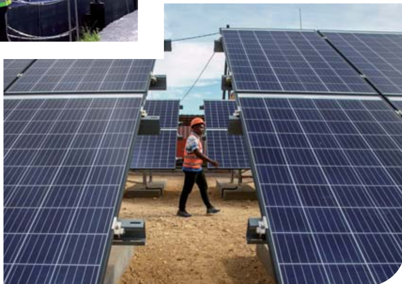
▶ A solar energy installation installed by Fondation Énergies pour le Monde
